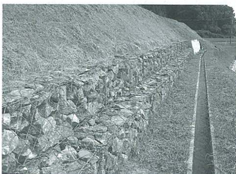
危険との指摘がある蛇籠工法による災害復旧
