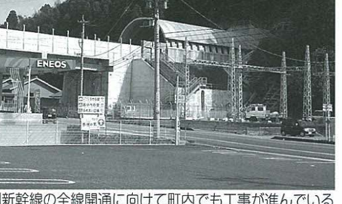
九州新幹線の全線開通に向けて町内でも工事が進んでいる
