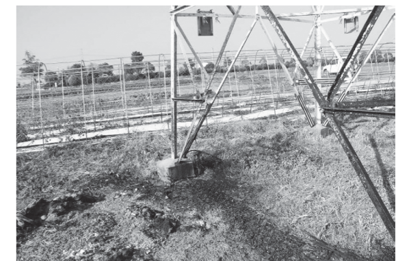
▲野焼きで焼損した鉄塔
