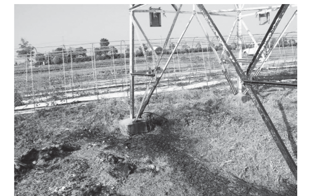
▲野焼きで焼損した鉄塔
