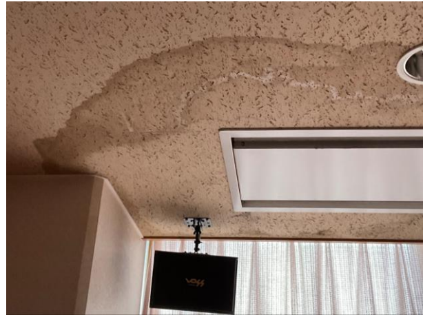
漏水跡とみられる天井のシミ
